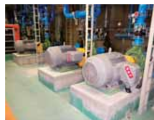
高効率送水ポンプへの切替
