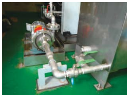
ポンプの下部に受け皿を設置
