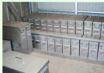
廃PCB含有電気機器の保管状況
