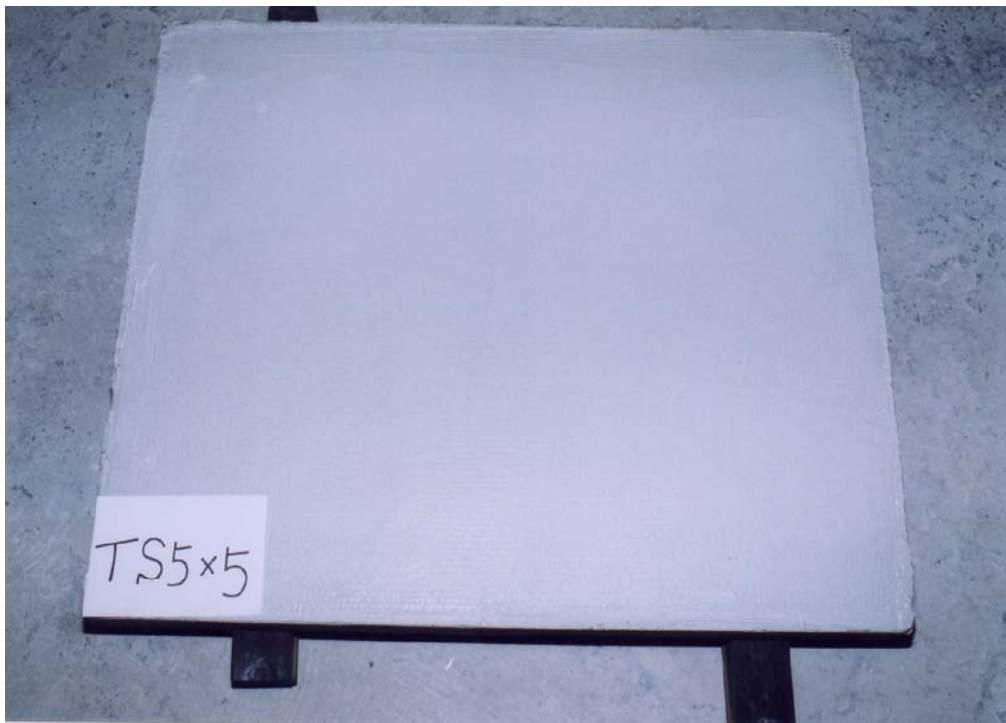
写真3 クラックの発生状況(ARGネットTS5x5)
