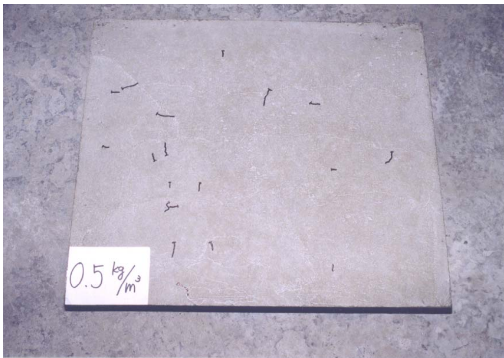
写真3 クラックの発生状況 (No. 2, 0.5 kg/m³)
